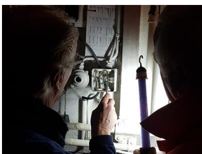
Onderhoud electra motorkamer
